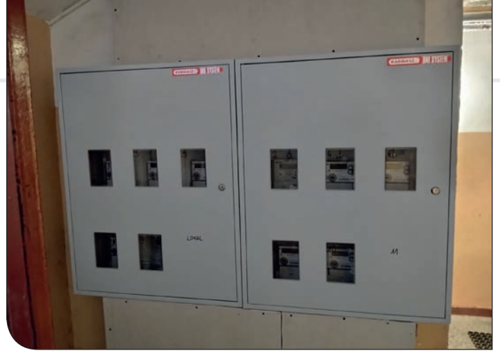
nowe szafy licznikowe
